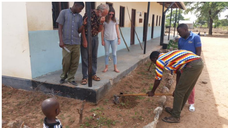
Abbildung 17: Defekte Regenwasserleitung, die teilweise ersetzt werden muss.
