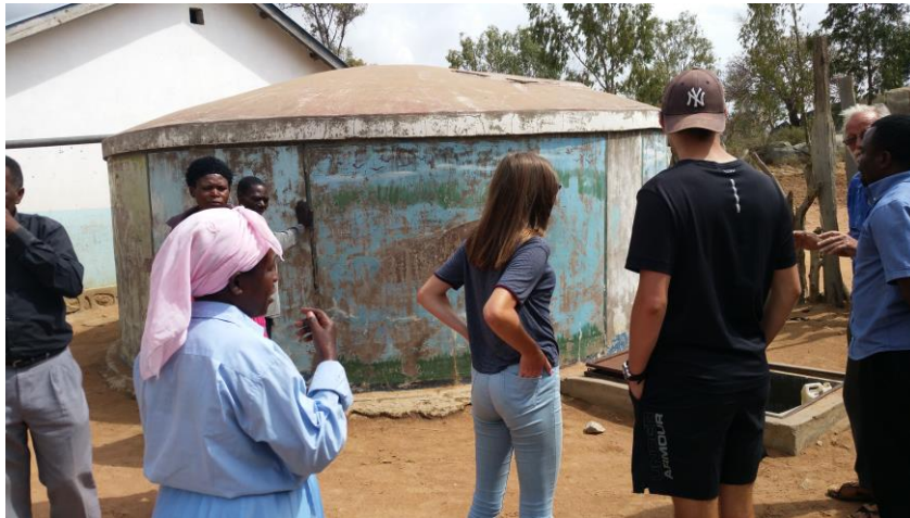
Abbildung 6: Der Wassertank muss wieder instandgesetzt werden.
