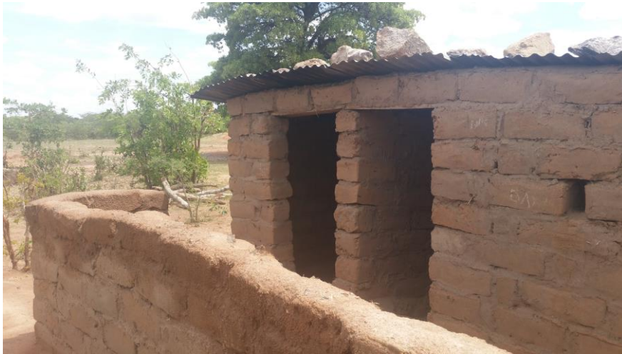
Abbildung 19: Bestehendes Toilettenhaus – hygienisch bedenklich.
